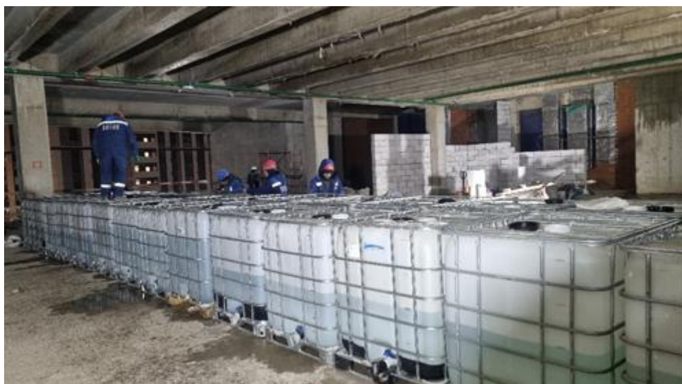
Рис. 7. – Емкости с водой «Еврокуб» на 1000л для создания нагрузки на испытываемую балку ребристого перекрытия
