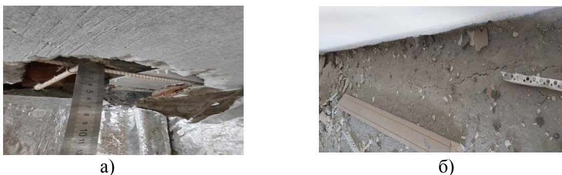
а) б) Рисунок 1 - Дефекты монолитных железобетонных плит перекрытия: а) механическое разрушение бетона плит с обнажением арматуры в местах прокладки коммуникаций; б) трещины
