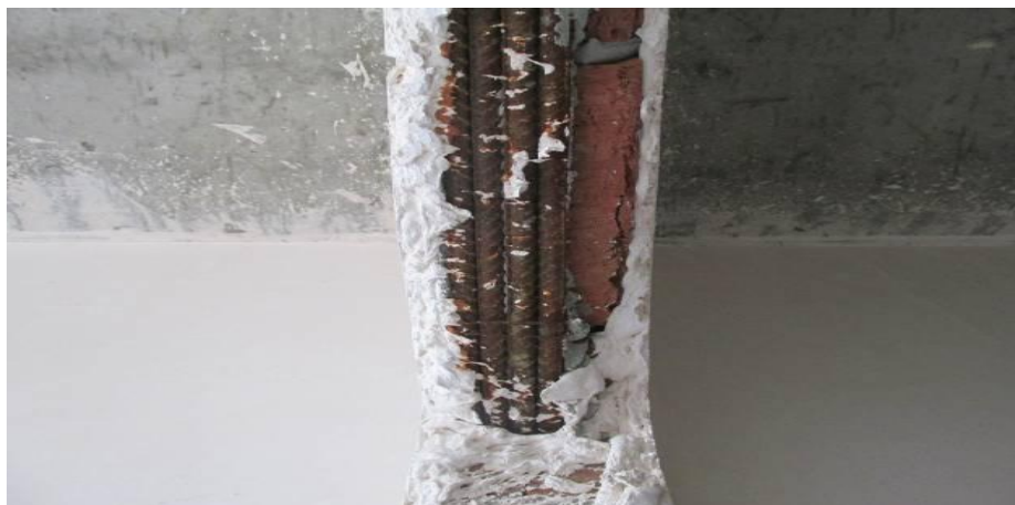
Рисунок 1– Нарушение защитного покрытия в перемычке
