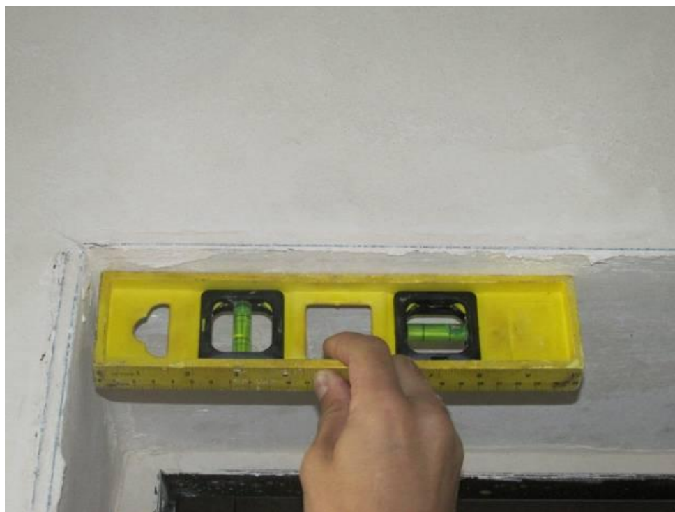
Рисунок 2 – Перекос перемычки дверного проема
