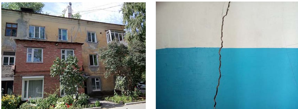
Рис. 1. Дефекты ограждающих конструкций в жилых зданиях
